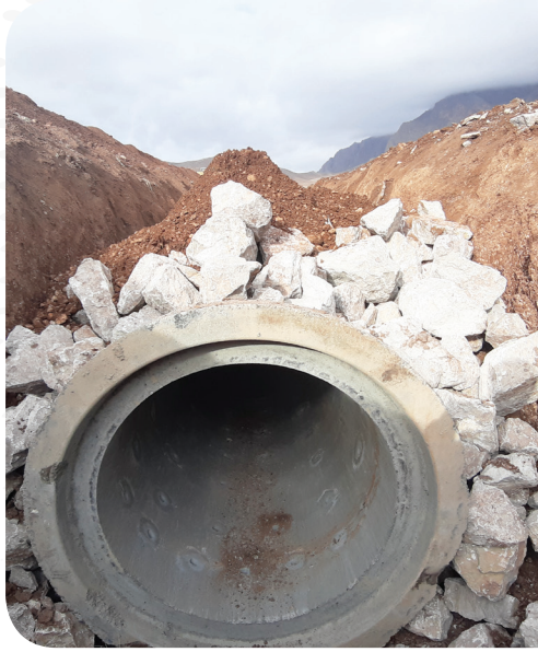
شکل ۵ خاکریزی و فیلتر ریزی روی گالری بتنی مشبک در سامانه قنات معکوس
