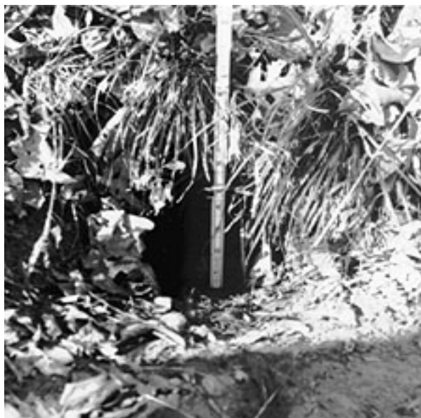
عکس شماره ۱۳ - سوراخ‌های ایجاد شده توسط حیوانات حفار (باعث شکست سد)
